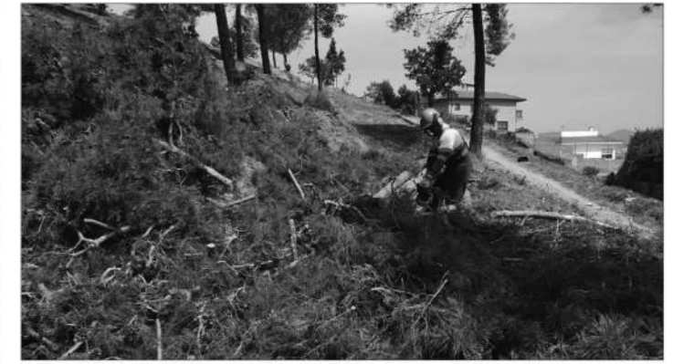
Creació d'una franja de protecció en una urbanització de Cervelló. DIPUTACIÓ DE BARCELONA
